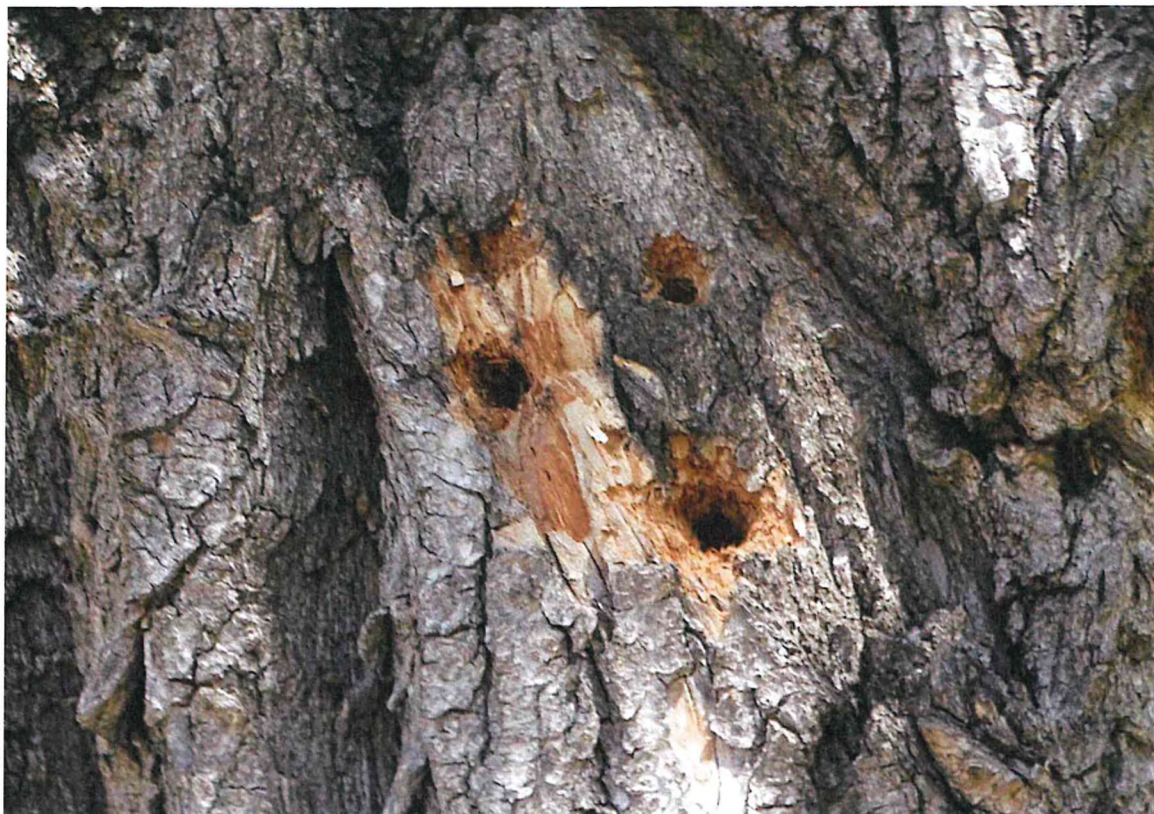
Obr. 10: Otvory od strakapoudů do stromu č. 17 potvrzují, že uvnitř žije hmyz
